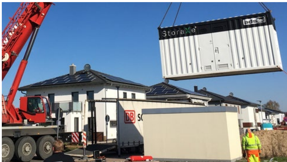
Abbildung 1: Installation eines Quartierspeichers in einer Wohnsiedlung [1]
