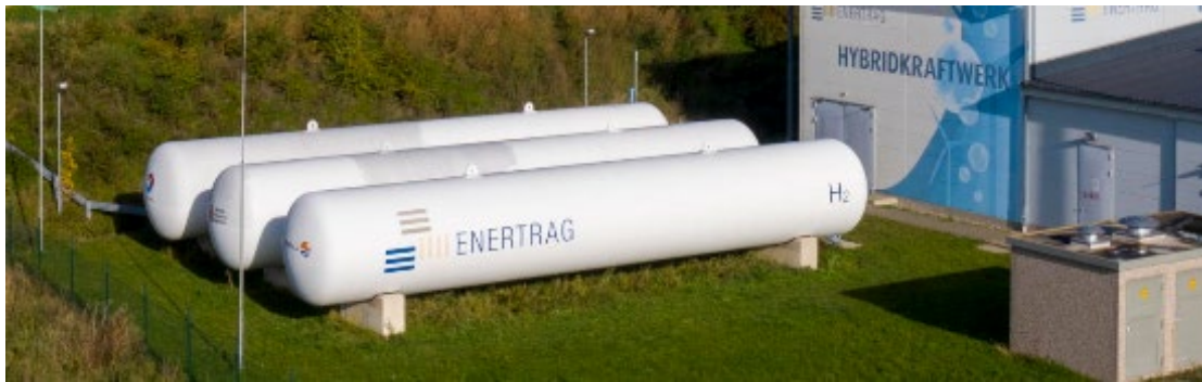
Abbildung 1: Wasserstoff-Druckspeicher neben einer Elektrolyse-Anlage [2]
