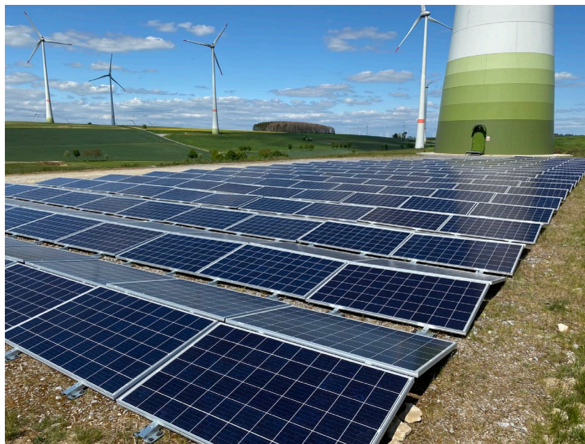
Abbildung 1: PV-Anlage auf einer Kranstellfläche [1]
