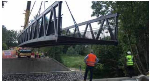
Brücke des Bahntrassenradwegs Aachen-Jülich über die Wurm bei Aachen-Haaren (Foto: StädteRegion Aachen)
